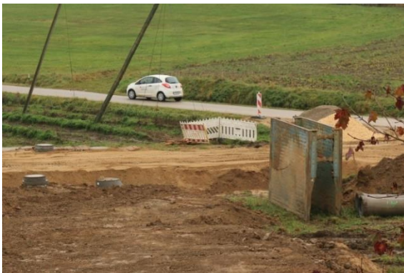
Baugebiet „Wirtsleit'n“ - ca. 90 cm erhöhte Erschließungsstraße und entsprechend aufgefülltes Gelände während der Erschließungsphase
