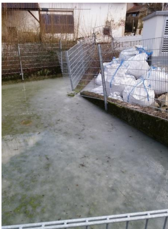
Die gebrochene Stützmauer am Feuerlöschteich in Rachertshofen macht's möglich - Gedanken über Neugestaltung des Dorfplatzes
